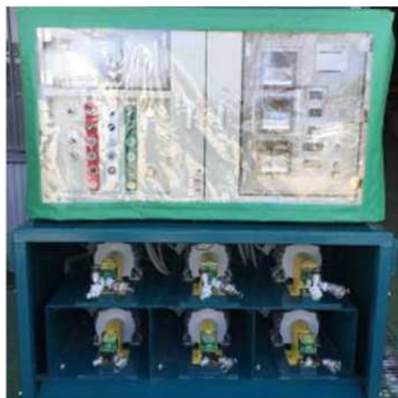
高圧注入機 3.7kwモータ (圧力上昇時流量自動制御)
