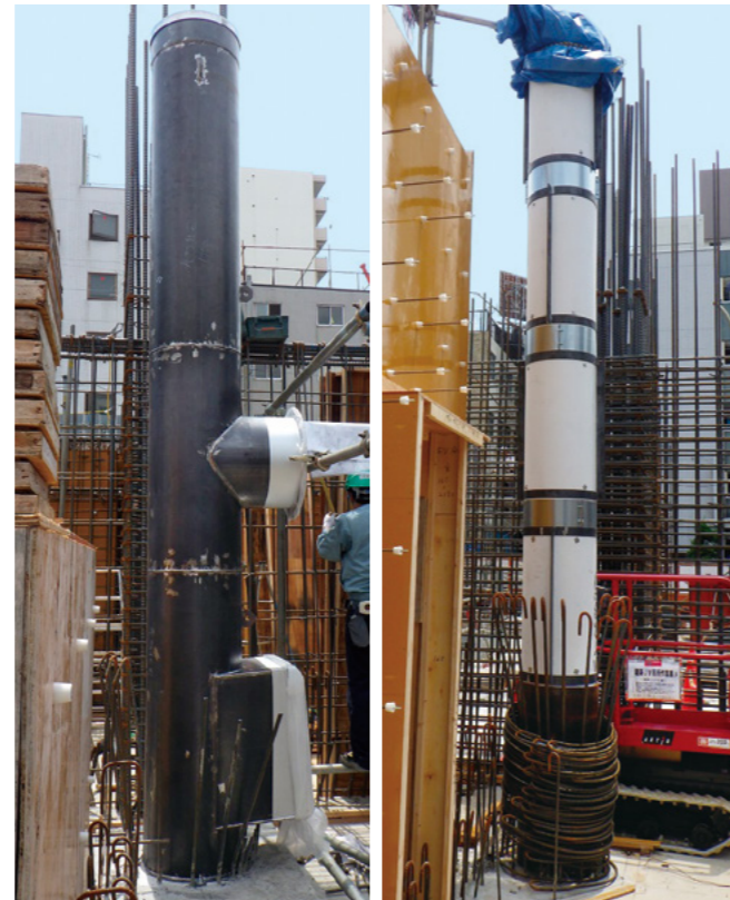
■煙道接続フロア
