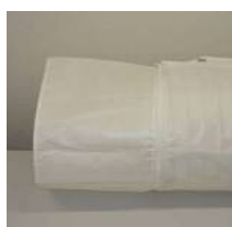
SAダクト、コネクター接続
