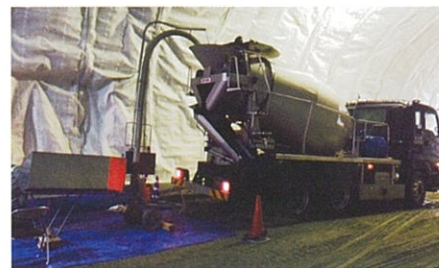
投入機 使用状況
